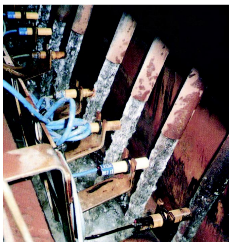
Контроль водяных струй
